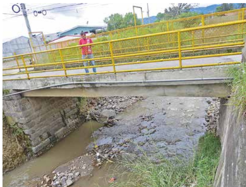
Probus realiza mediciones a los cauces de los ríos para construir modelos de inundaciones y estudiar posibles impactos en la infraestructura del sistema vial, como esta en La Lima de Cartago, hecha por el asistente de Ingeniería Civil, José Quirós Campos (foto cortesía Probus).
